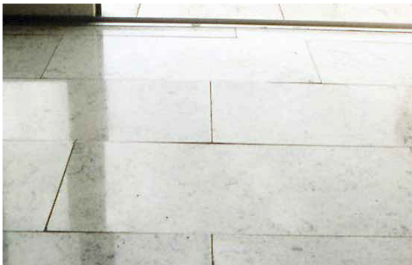
„Verschüsselte“ Platten am Tag nach der Verlegung, verursacht durch falsche Kleberwahl.
