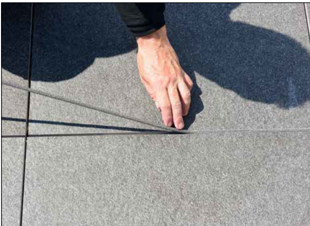
9 Eingeplante Bewegungsfugen sind mit einer Hinterfüllschnur zur Vermeidung einer Dreiflankenhaftung zu füllen.
